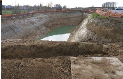
Bassin de rétention d'eau de pluie pour limiter le débit en cas d'orage
